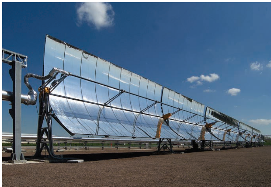
■ Impianto Prova Collettore Solare (PCS), Centro Ricerche ENEA Casaccia
