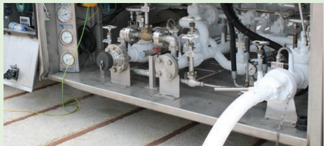
■ Dettaglio del sistema di trasferimento e pompe criogeniche con i rivestimenti esterni che sviluppano ghiaccio
