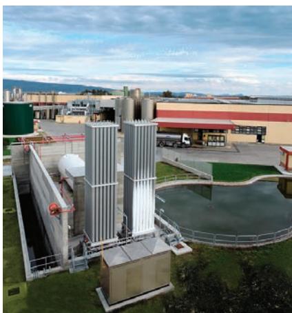
■ Deposito di GNL
