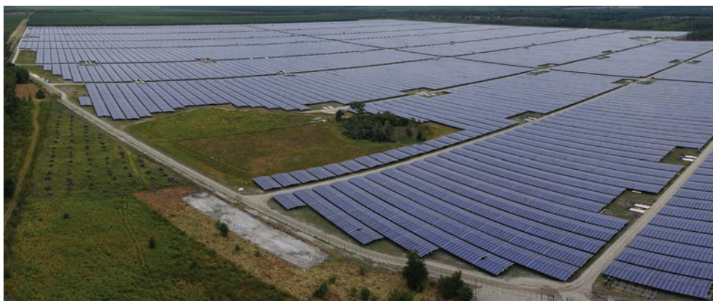
■ Il più potente impianto fotovoltaico d'Europa situato a Bordeaux in Francia [Parc photovoltaïque Cestas]
