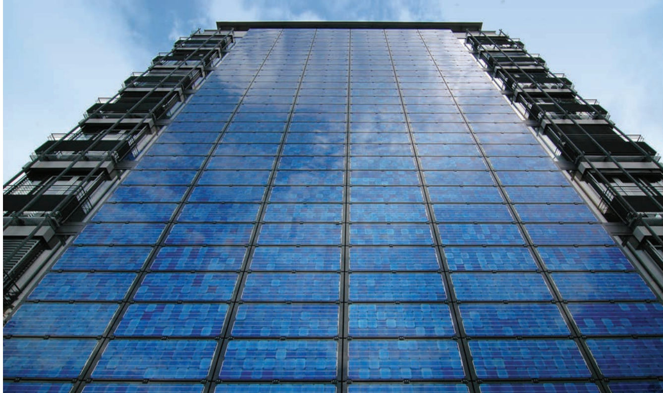
■ Facciata fotovoltaica ventilata realizzata con moduli senza cornice ed apposito sistema di montaggio
