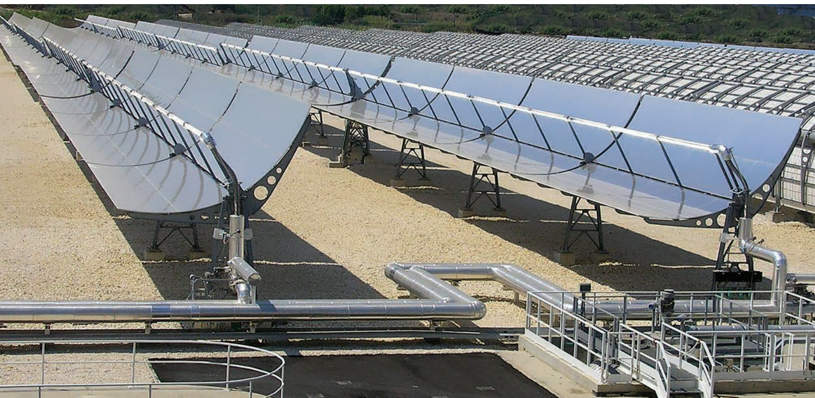
■ Solare termodinamico, collettori parabolici lineari a sali fusi, l'energia della terza rivoluzione industriale
