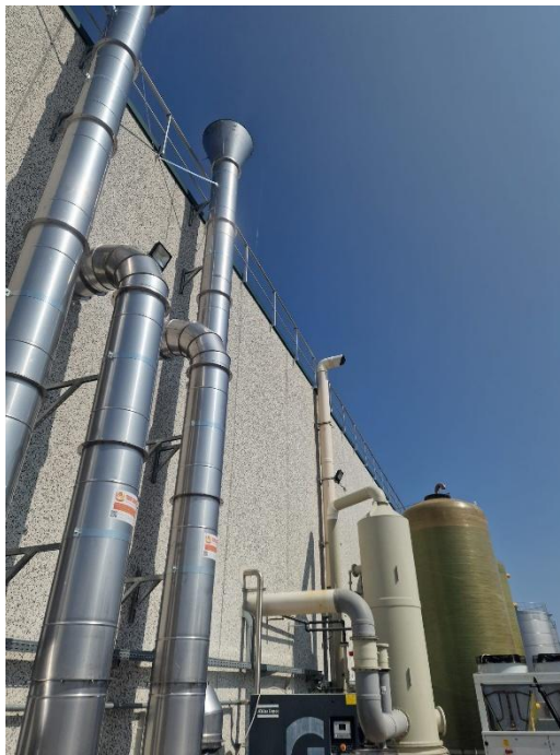
Sistema captazione e depurazione emissioni
