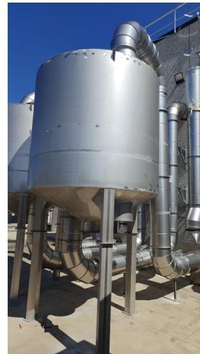
Sistema di filtraggio a carboni attivi
